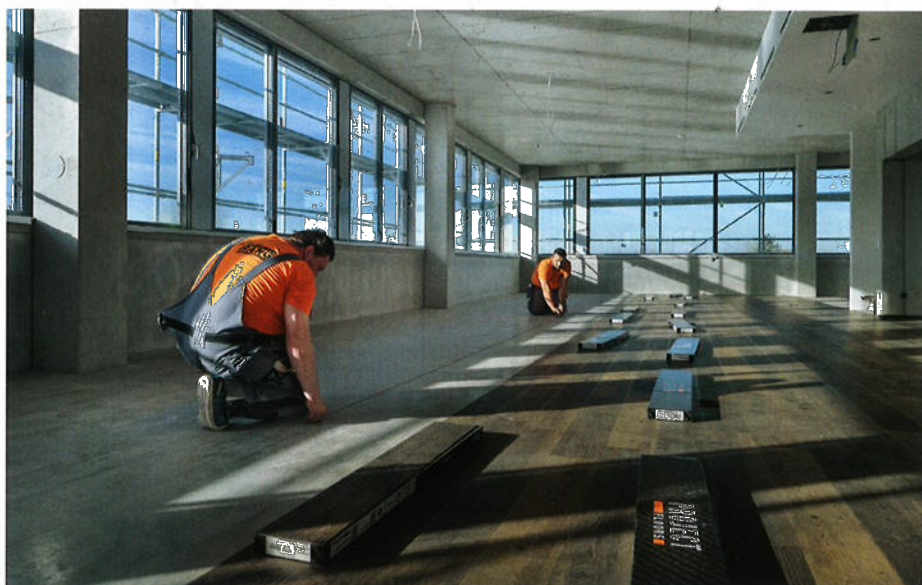
Nach der fachgerechten Untergrundvorbereitung mit verschiedenen Produkten der Uzin Utz Group konnte die Verlegung der Designbeläge beginnen.
